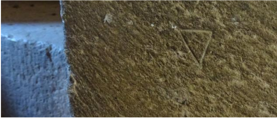
Fotografía 77. En la pared a la derecha al iniciar las escaleras.
