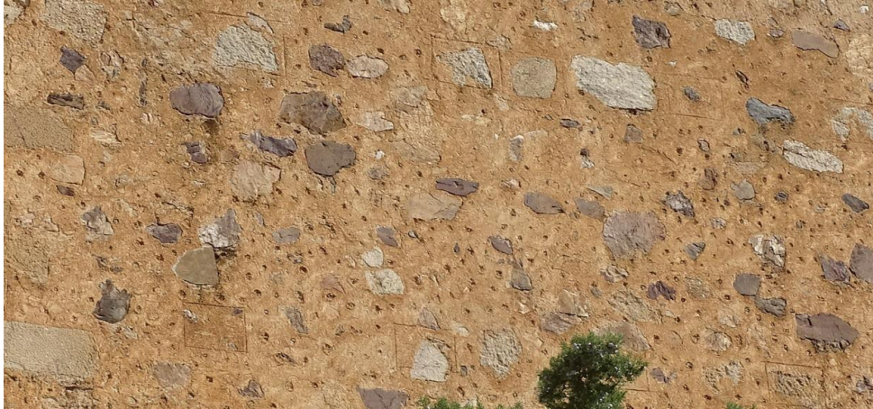
Fotografía 114. Vista de parte de la pared donde aparecen rectángulos marcados en enfoscado ya deteriorado por la erosión.
