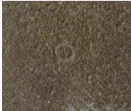
Fotografía 108. En pared a la derecha de una puerta.
