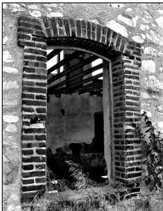
IMAGEN 11. FOTOGRAFÍA REPRESENTATIVA DEL ESTADO DE DETERIORO DE LA FÁBRICA
